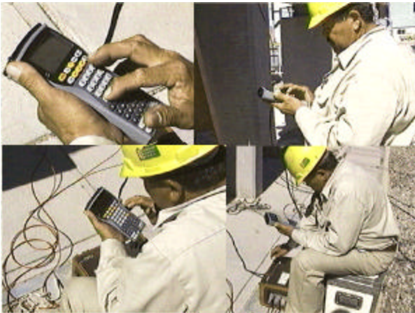
Especialista en Subestaciones con la microcomputadora de mano, recolectando los datos de prueba durante un mantenimiento.
