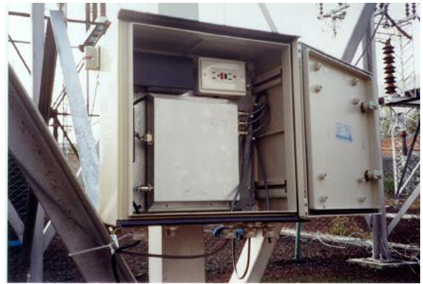
Fotografía 1. Módulo de medición de corrientes capacitivas instalado en la S. E. “El Álamo” de CFE.
